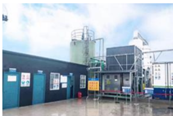
湖北洪湖渗滤液全量化处理项目
