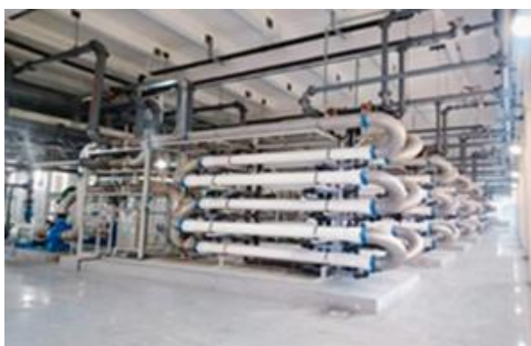
华电集团邹县电厂软化除硬项目
